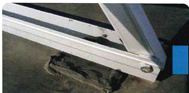
コーキング部分から建物に水が入る
